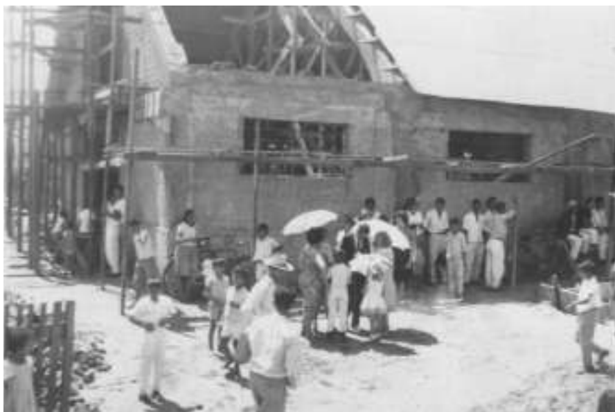
Novo Templo, após tempestade que danificou seu telhado.
